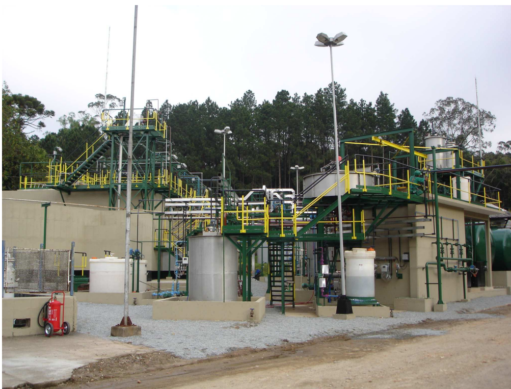
Foto 2. Vista da Estação de Tratamento de Efluentes. (INDÚSTRIA PETROQUÍMICA, 2008)
