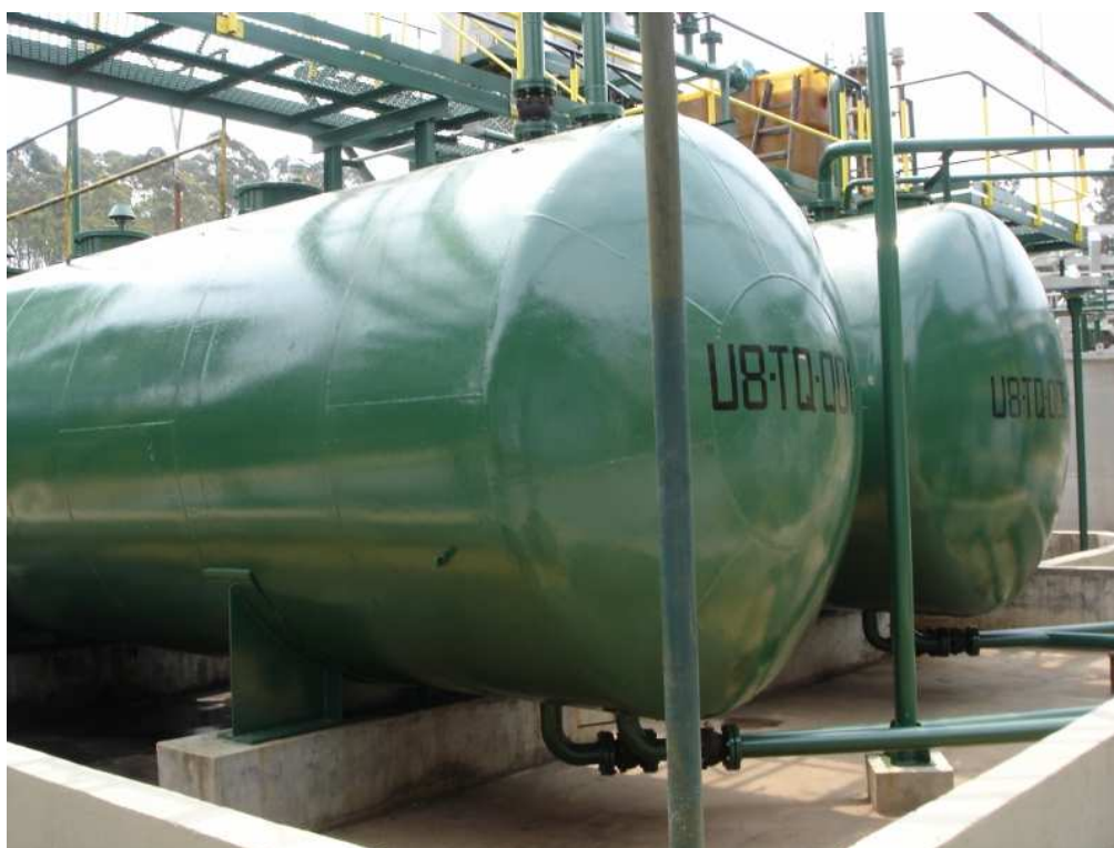
Foto 3. Tanque de Equalização - U8-TQ-002. (INDÚSTRIA PETROQUÍMICA, 2008)
