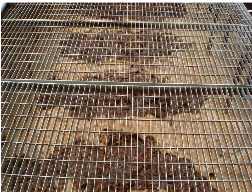
Foto 8. Tanque de Aeração por Membranas - TAM-001. (INDÚSTRIA PETROQUÍMICA, 2008)
