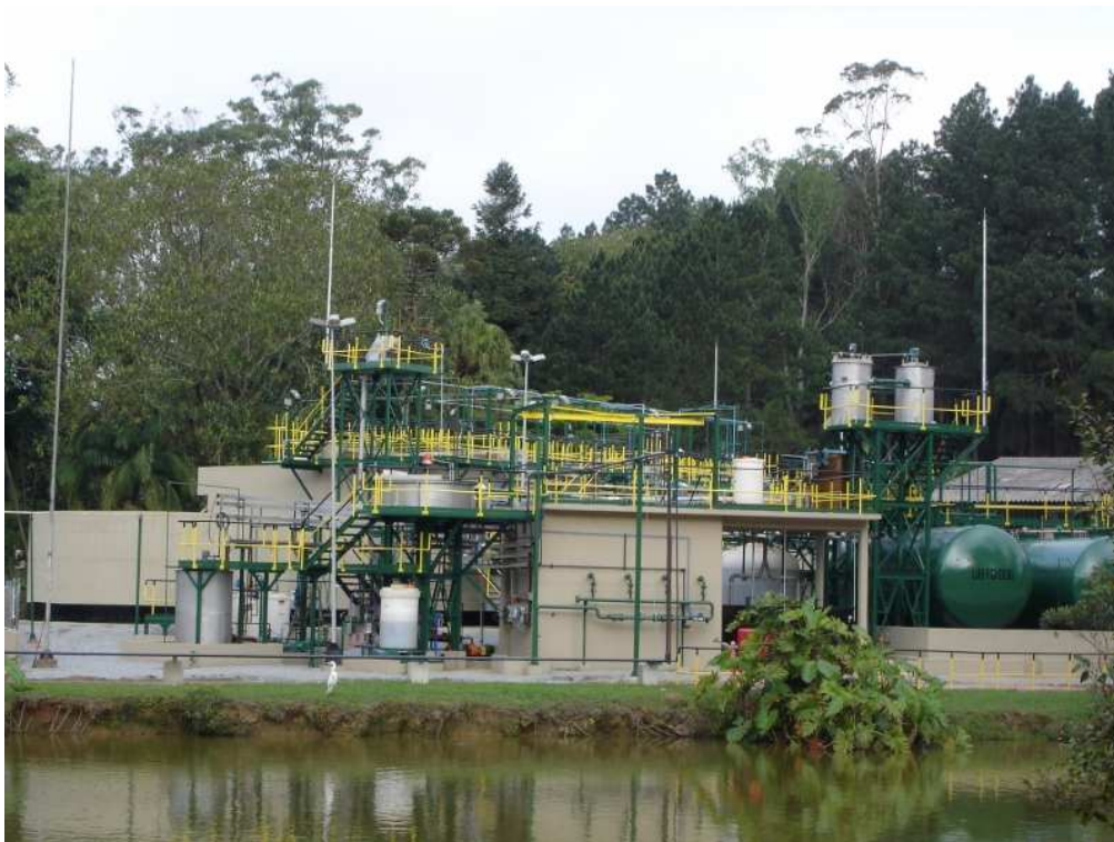
Foto1. Vista da Estação de Tratamento de Efluentes. (INDÚSTRIA PETROQUÍMICA, 2008)
