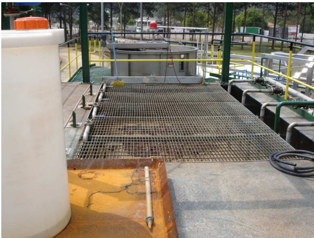
Foto 7. Tanque de Aeração por Membranas - TAM-001. (INDÚSTRIA PETROQUÍMICA, 2008)
