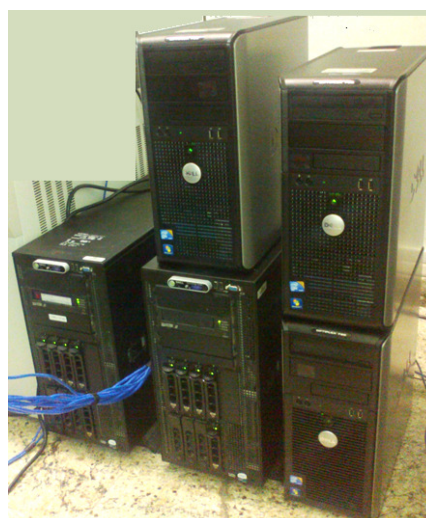
Figura 7 – Equipamentos anteriores à consolidação
