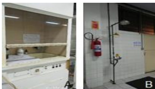
Figura 6 – Capela química com exaustão (A) e chuveiro, lava-olhos e extintor de incêndio perto da porta (B).
